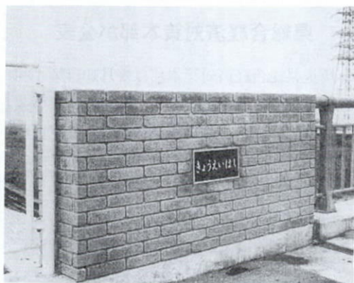
写真はレンガ（深谷市）利用の深谷市内共栄橋道路工事の事例（熊谷土木事務所発注）
