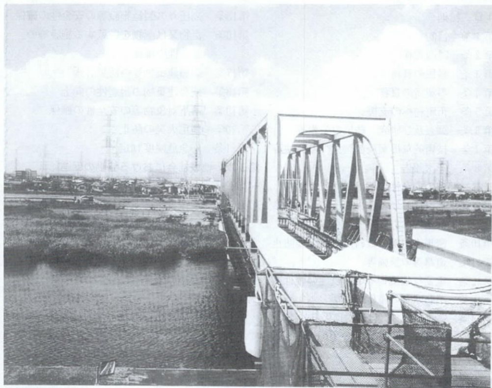
工事中のつくばエクスプレス中川橋梁 （三郷側から八潮市を見る）
