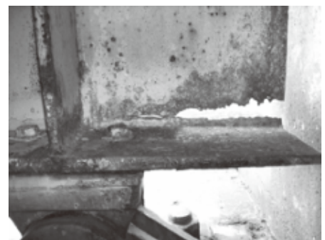
図2 鋼橋桁端部の腐食
