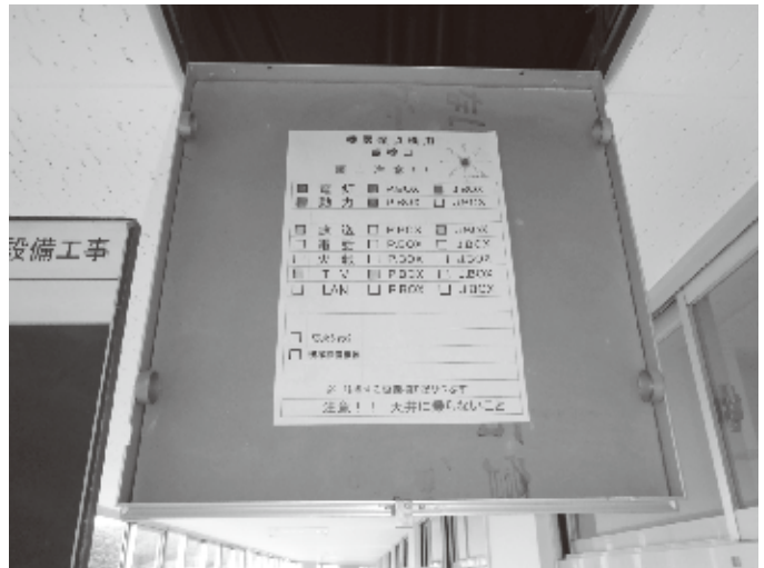
(③点検口に設置機器の表示をした事例)
