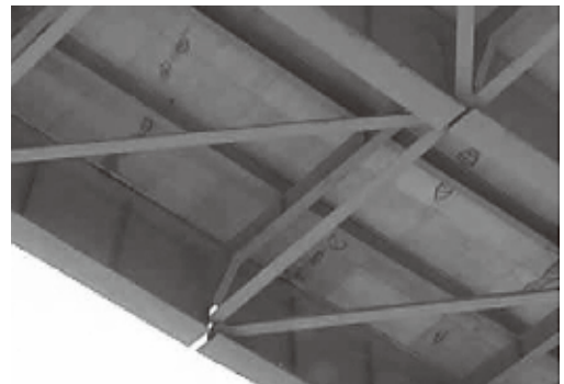
図1 疲労き裂から脆性破壊 (米国 Hoan Bridge 1) )
