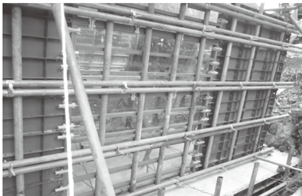
透明なアクリル板型枠。コンクリート打設時のパイプレーターのかけ方や気泡の状況を確認・把握し品質向上に貢献
