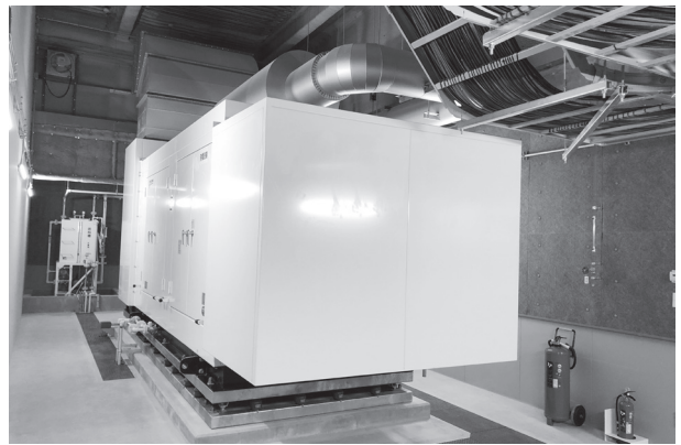
4階 非常用発電機
