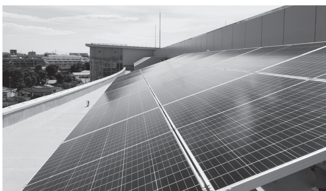
屋上 太陽光発電設備
