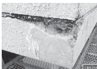
コンクリート爆裂
