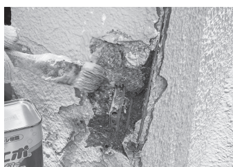
コンクリート欠損
